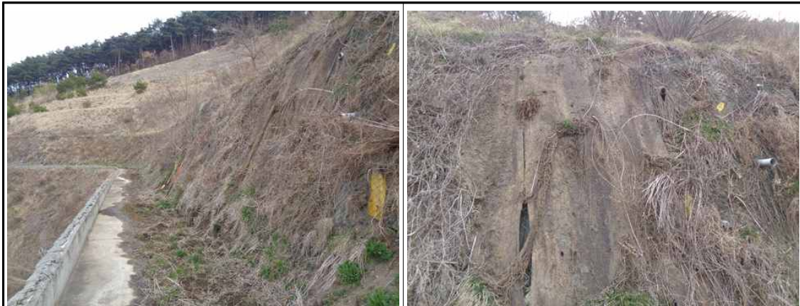
㉠ (2/3) STA.0+0 2단 녹생토 유실, 누수 ⇨ 주의관찰 후 조치
