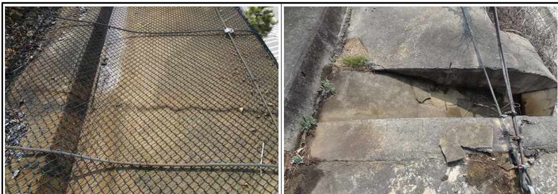
④ 10.80K 1소단배수로 균열 ⇨ 균열보수
